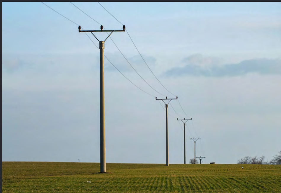
Jednozávěsy a dvojjávěsy tvoria najčastejšie konštrukcie vedenia 22 kV v krajine. (M. G.)
